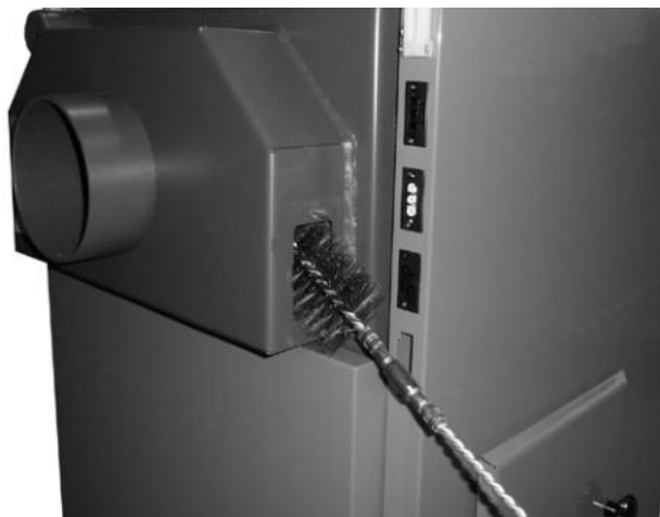
Vorführung der Reinigung des Rauchkanals. Wird nach Reinigung des Rohrbündels in Verbrennungskammer des Kessels durchgeführt
